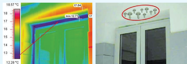
V místech ostění, kde je teplota stěny nižší než +13 °C dochází ke kondenzaci vzdušné vlhkosti
